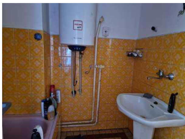
2. NP - koupelna + elektrický bojler
